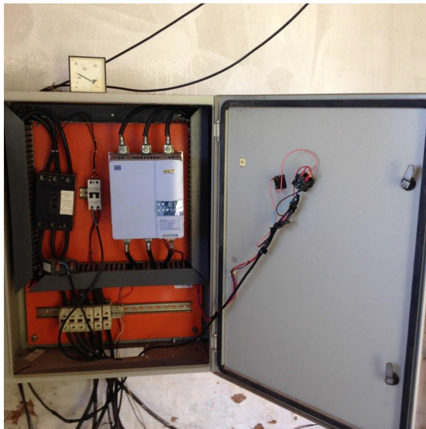
Foto: 41 – Painel de comando do conjunto motor/bomba de 50 Cv. (parte interna)
