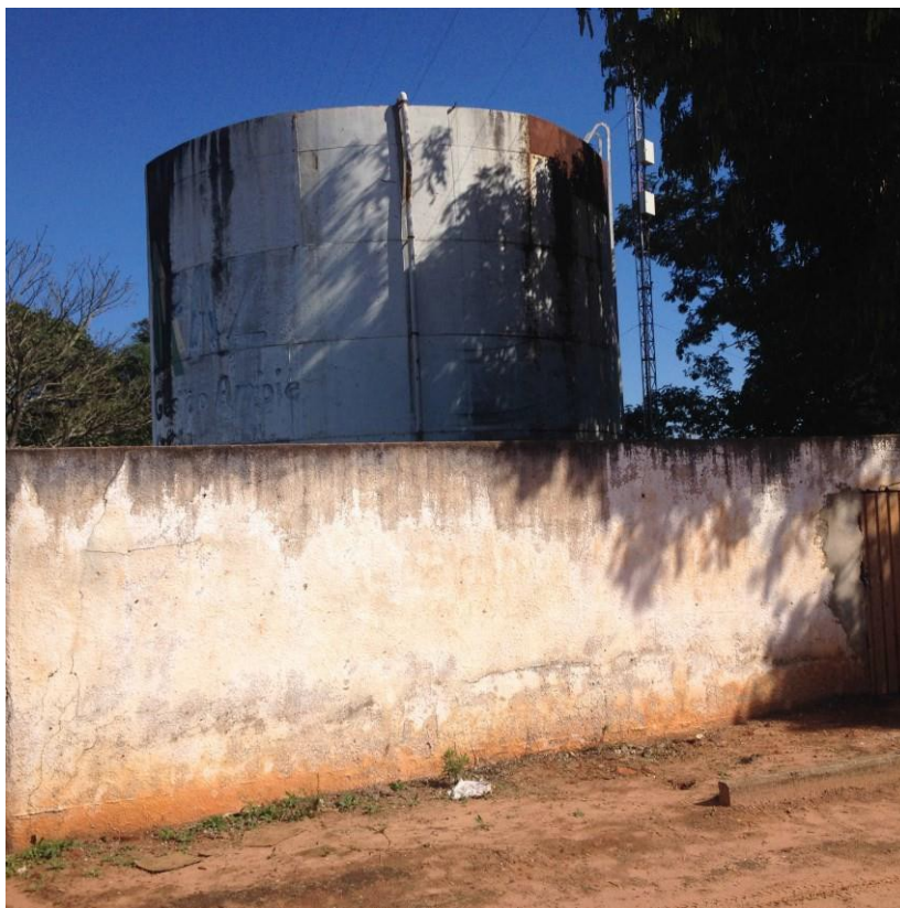
Foto: 15 – Reservatório da Piscina – Capacidade: 250m 3 - Localização: Rua Seis de Agosto / Ao lado Rua Joaquim Cardoso Felício.
