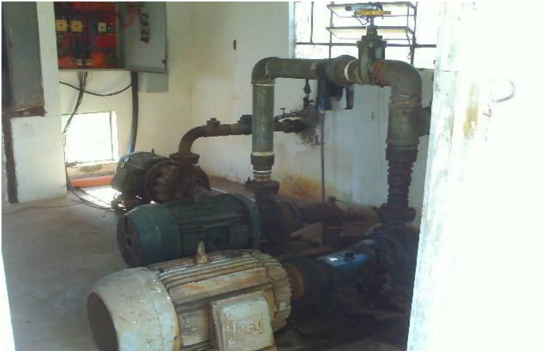
Foto: 35 – Bombas de recalque – 50 Cv e 40 Cv
