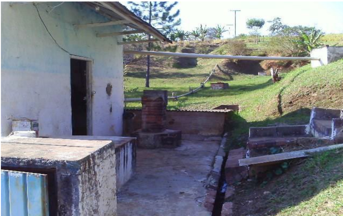
Foto: 28 – Visão parcial da casa das bombas – Ao fundo, rede de recalque.
