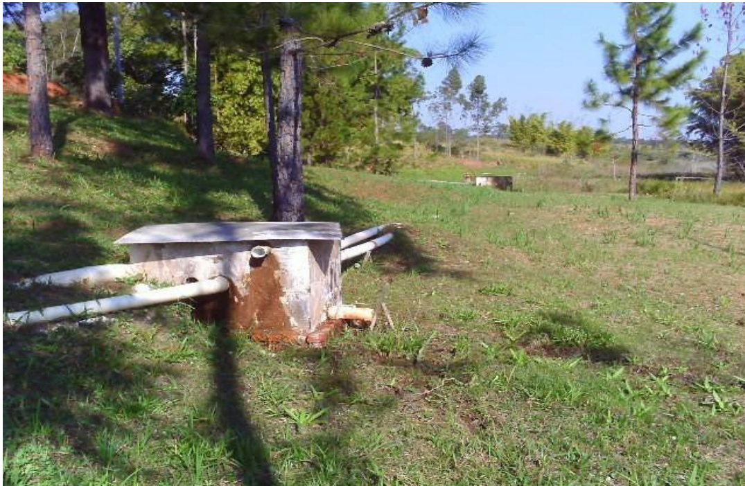
Foto: 17 – Caixa receptora da água das minas – Adução por gravidade
