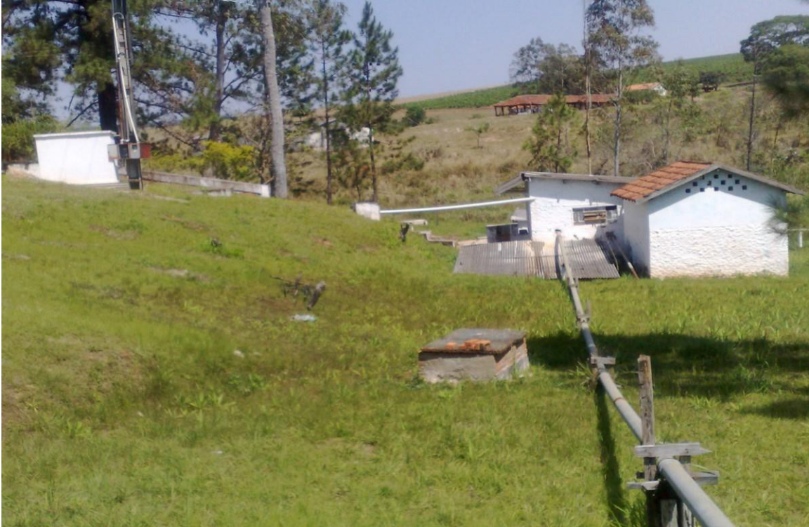
Foto: 29 – Visão lateral da casa das bombas. Nesta imagem temos vista parcial da rede de recalque, reservatório n.º. 1 de recepção de água das minas e parte da rede de recalque de 100 mm.
