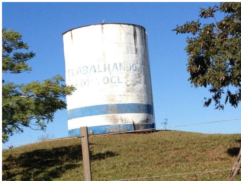
Foto: 11 - Reservatório do Trevo – Capacidade 180m 3 - Localização: Trevo na entrada de Cabralia Paulista - Rodovia – SP 293.
