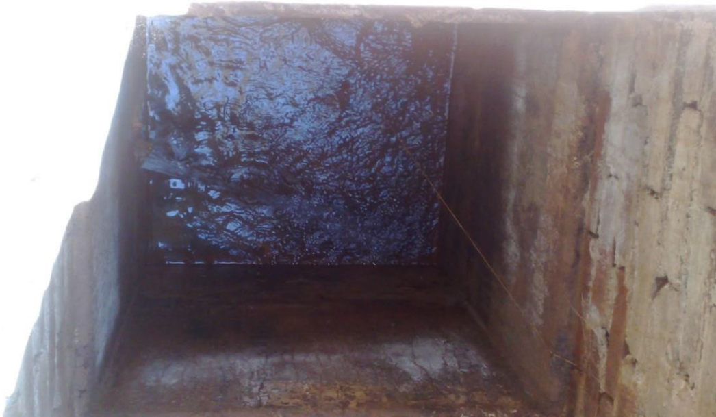
Foto: 33 – Visão interna de uma caixa de proteção, onde há uma mina de água em plena atividade.
