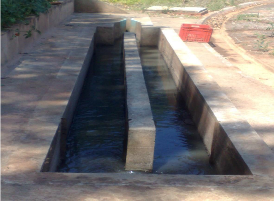
Foto: 49 – Caixa de areia e calha do sistema de tratamento de esgoto
