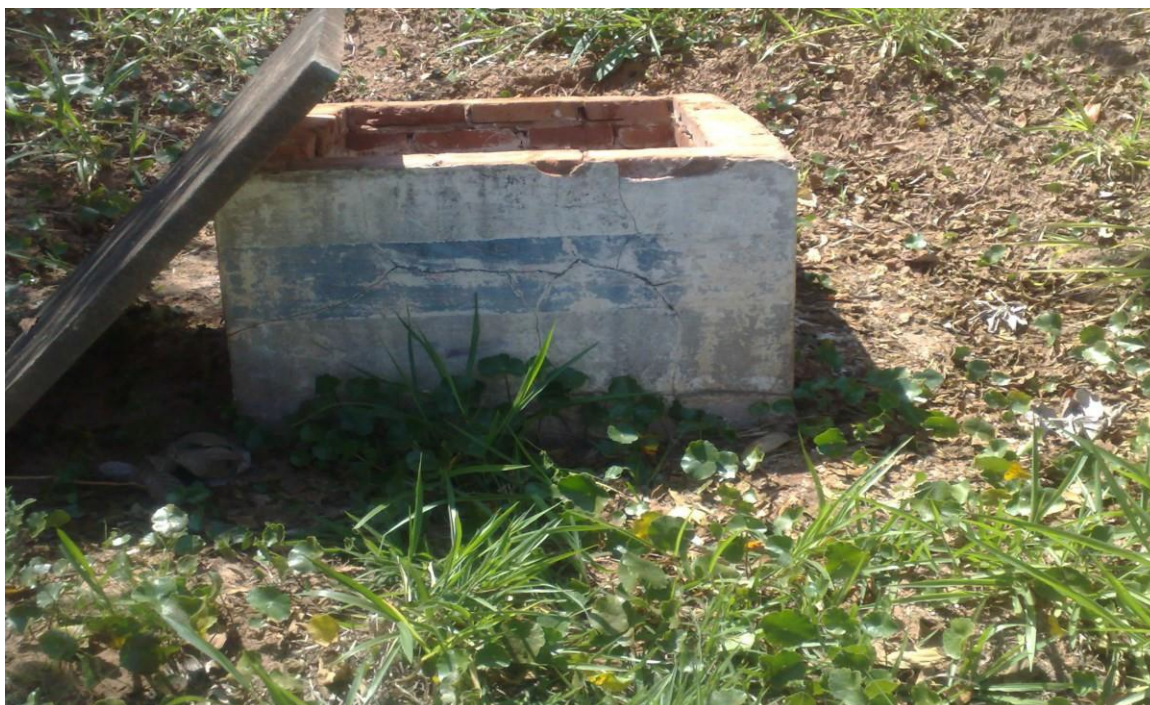
Foto: 32 – Visão externa da caixa de proteção da mina (ativa), com tampo retirado/aberto.
