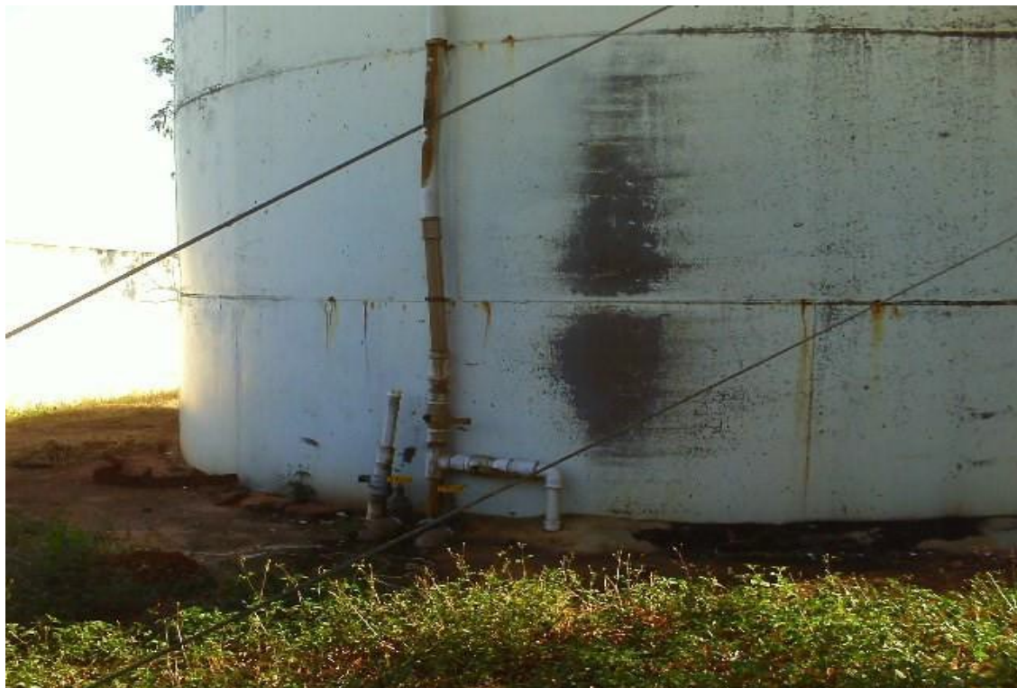
Foto: 16 – Reservatório da Piscina: A base deste reservatório está comprometida (infiltrações)
