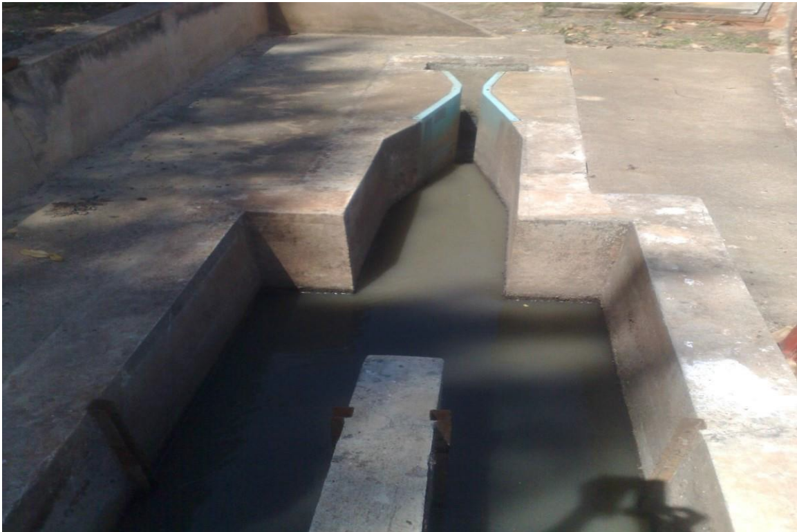
Foto: 51 - Calha Parshall
