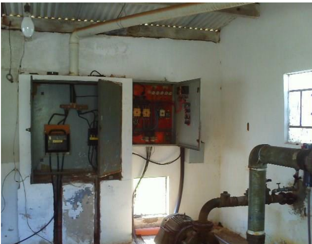
Foto: 36 – Chave central de energia e Painel de comando do conjunto motor/bomba de 40 Cv.
