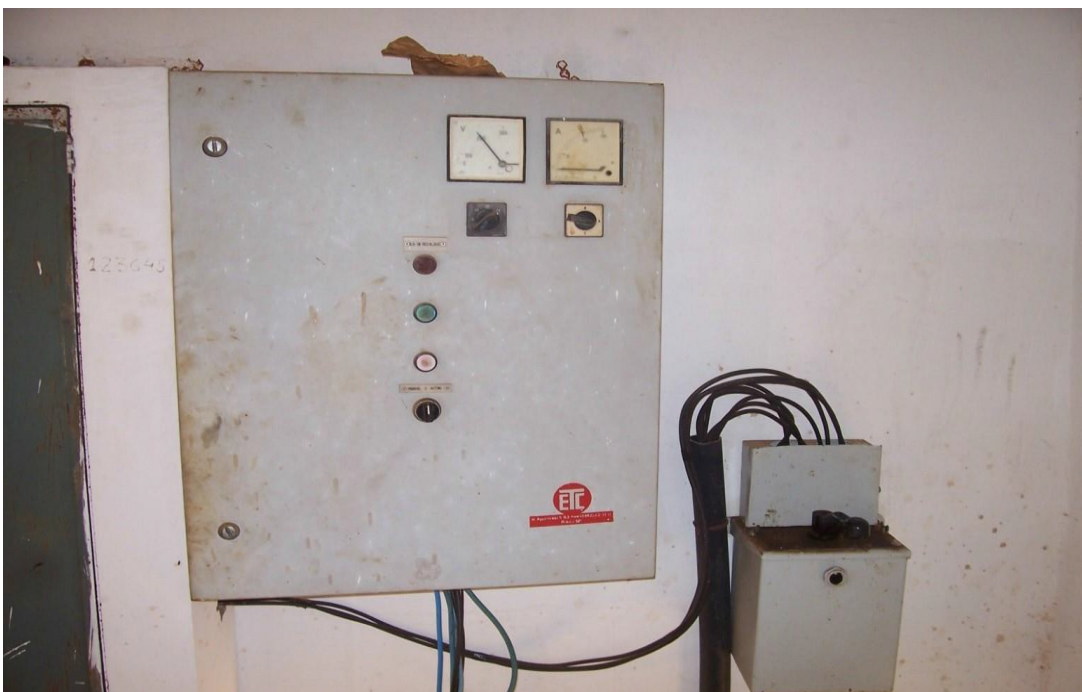
Foto: 38 – Painel de comando do conjunto motor/bomba de 40Cv
