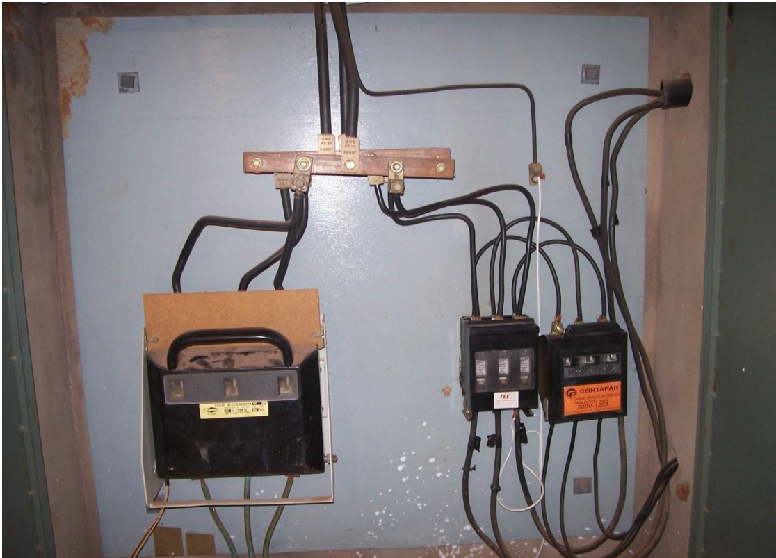
Foto: 37 – Chave geral de energia dos quadros de comando
