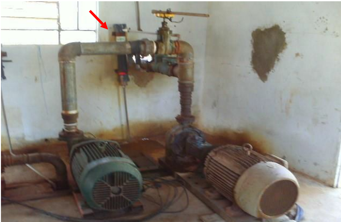
Foto: 34 – Bombas de recalque – 40 Cv e 50 Cv – Vazão aproximada de 38m 3 /h e 48m 3 /h respectivamente – No centro (fixado na parede), bomba dosadora de cloro e flúor. (Ver seta indicativa).
