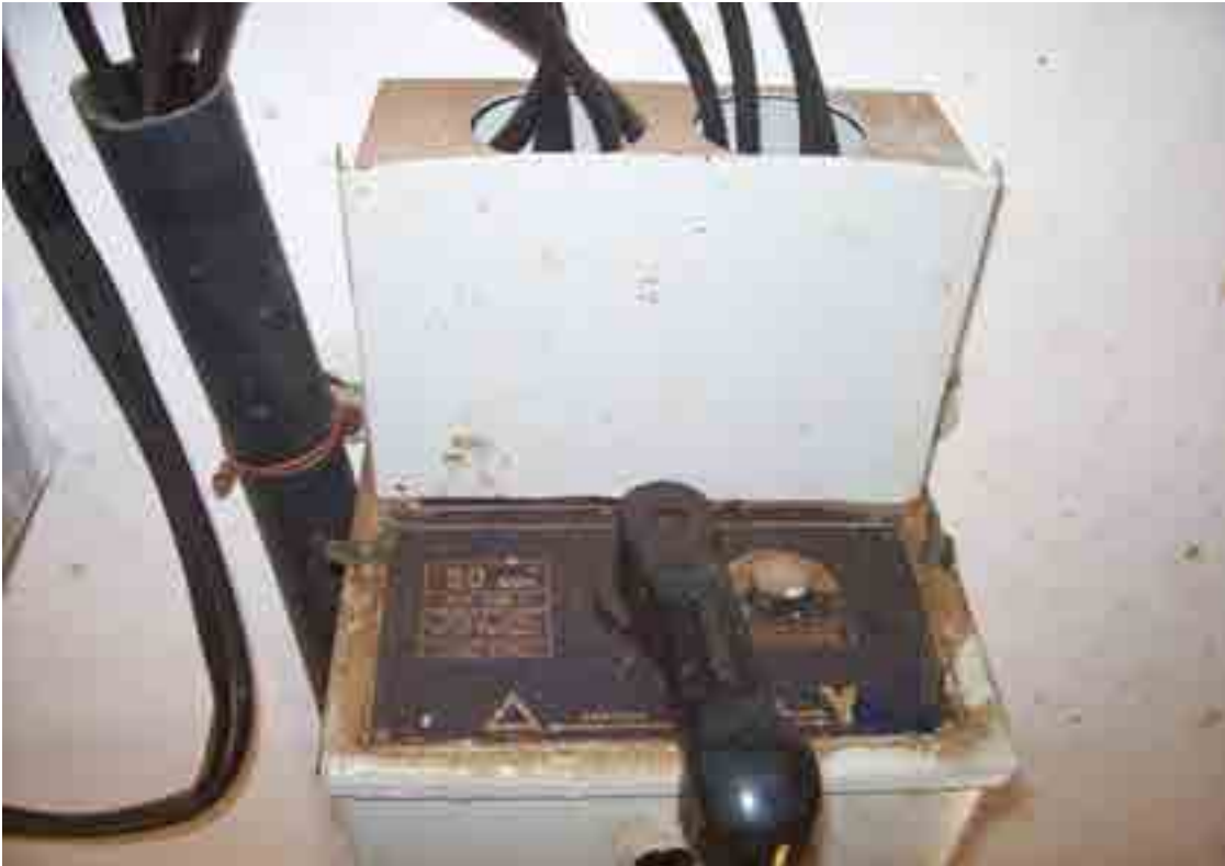
Foto: 39 – Chave de comando do conjunto motor/bomba de 40Cv.
