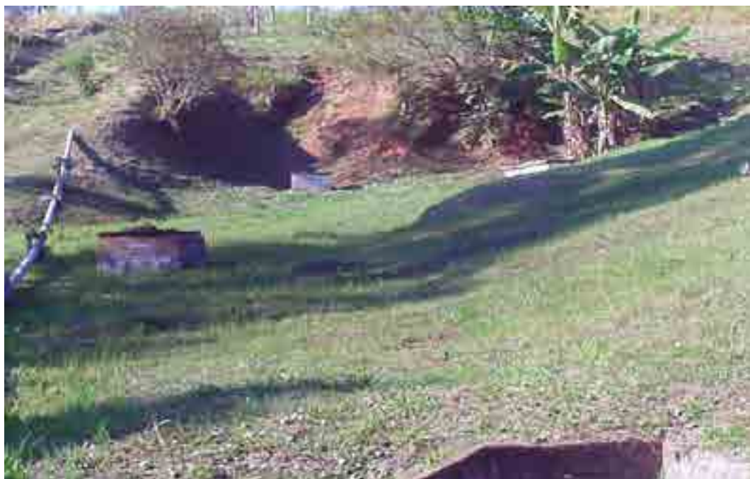
Foto: 18 – Caixas de proteção das minas – À esquerda temos uma visão parcial da adutora de recalque em direção ao centro do município.
