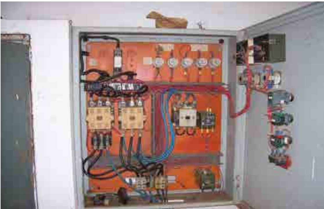
Foto: 40 – Painel de comando do conjunto motor/bomba de 40 Cv. (parte interna)
