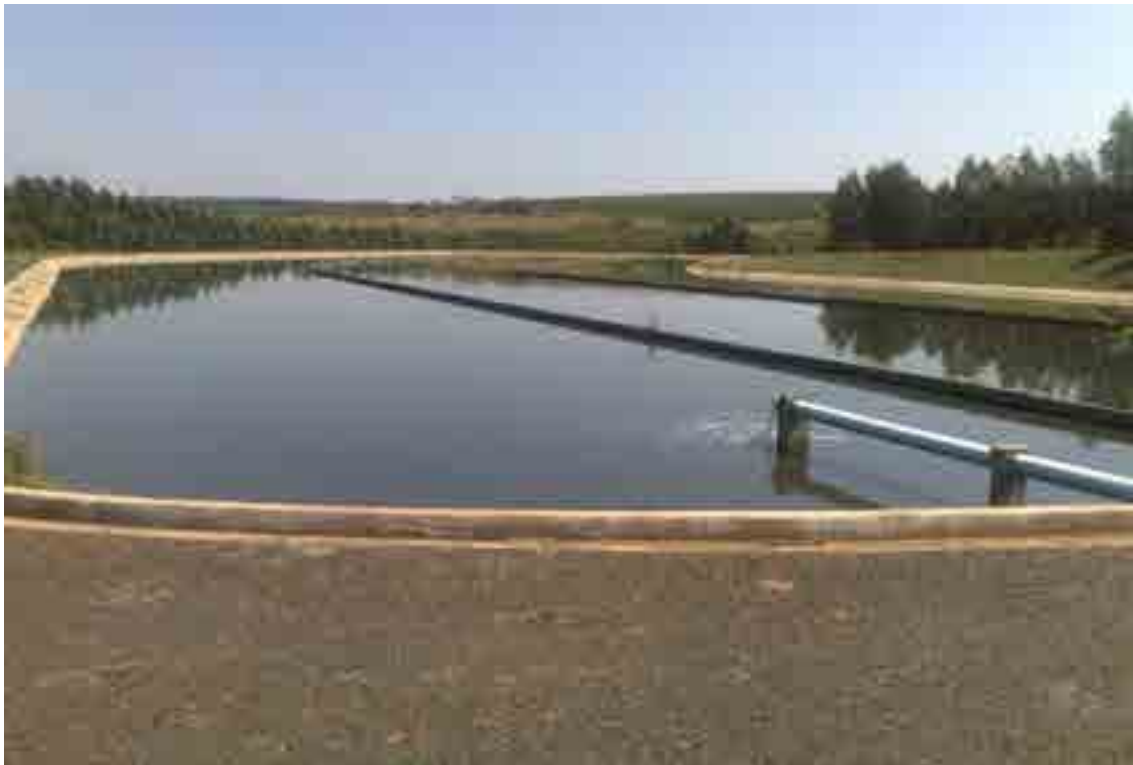
Foto: 55 - Visão-I – Vista parcial da 2ª lagoa (facultativa)
