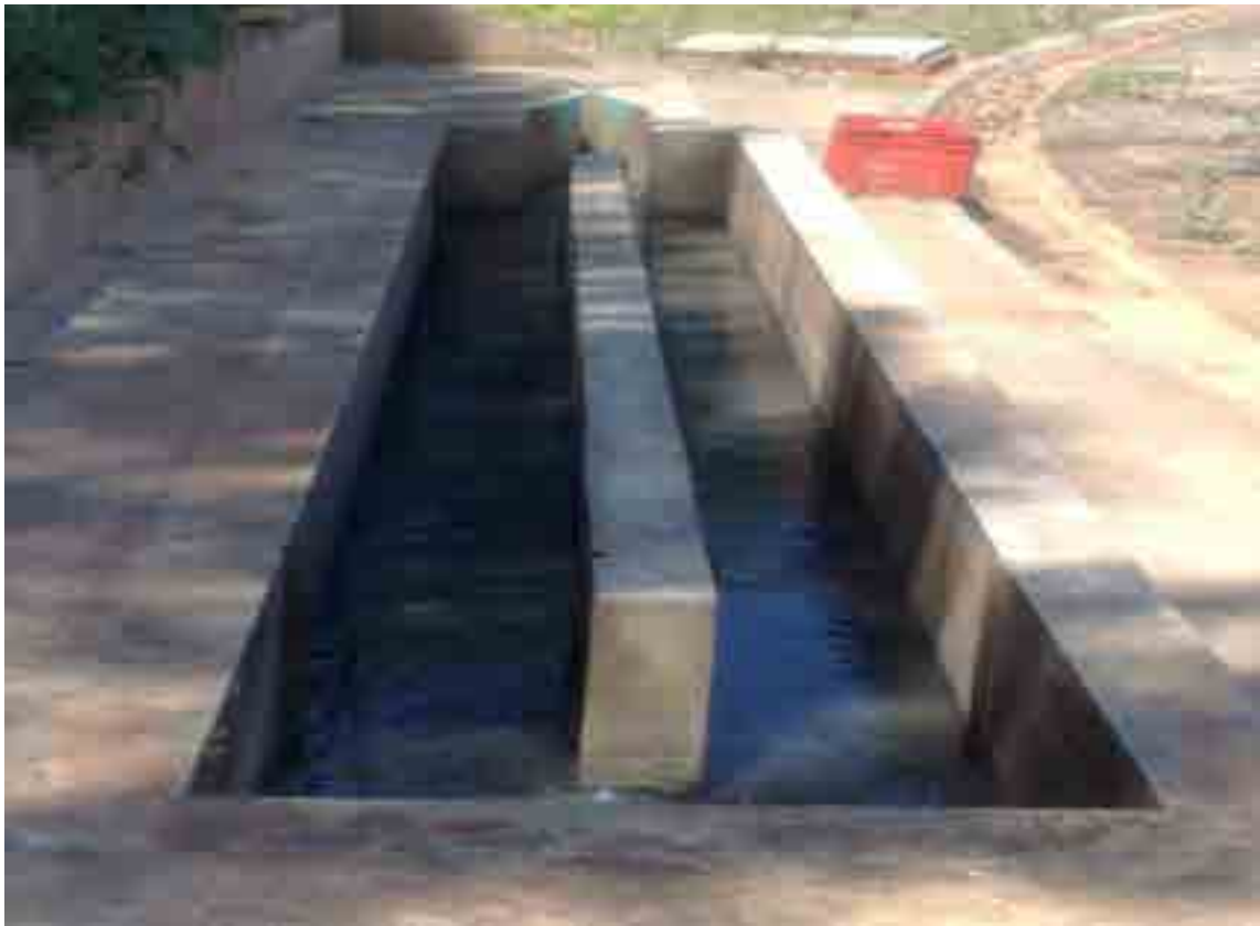
Foto: 49 – Caixa de areia e calha do sistema de tratamento de esgoto
