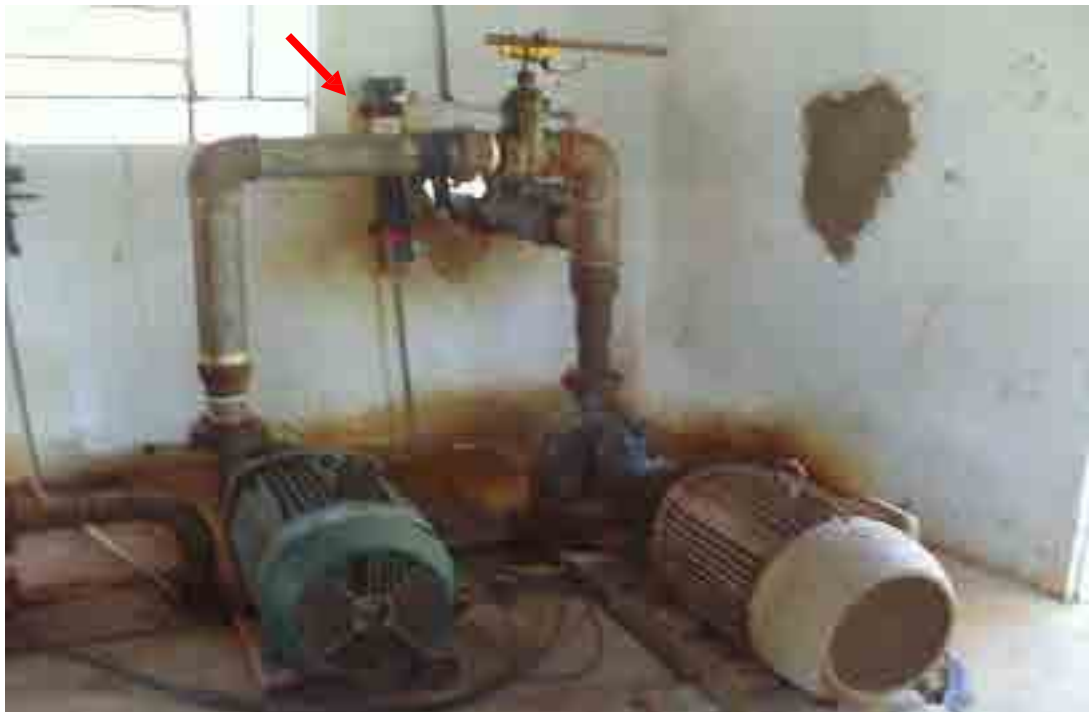
Foto: 34 – Bombas de recalque – 40 Cv e 50 Cv – Vazão aproximada de 38m 3 /h e 48m 3 /h respectivamente – No centro (fixado na parede), bomba dosadora de cloro e flúor. (Ver seta indicativa).
