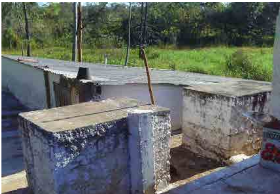
Foto: 24 –Reservatório semienterrado nº 2 – Capacidade 25m 3
