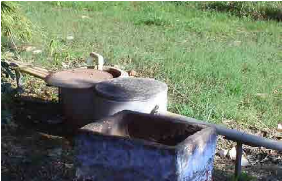
Foto: 21 – Caixas de recepção e passagem da água das minas e represas em direção ao reservatório semi-enterrado p/respectivo tratamento e distribuição.
