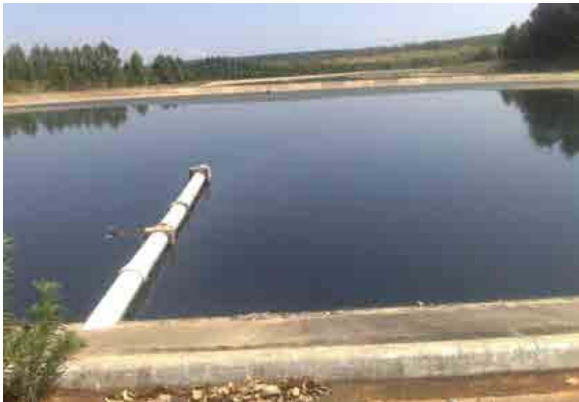
Foto: 52 – Vista parcial da lagoa anaeróbia (1ª lagoa)
