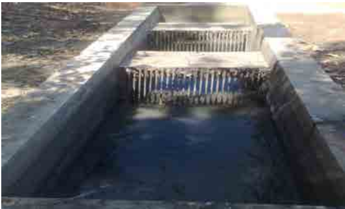
Foto: 50 – Caixa de gradeamento da lagoa de tratamento
