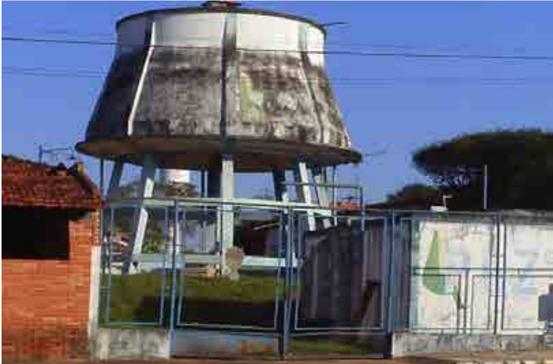
Foto: 06 – Reservatório Elevado Central - Capacidade de 360m 3 - Localização: Rua Manoel Francisco - Centro
