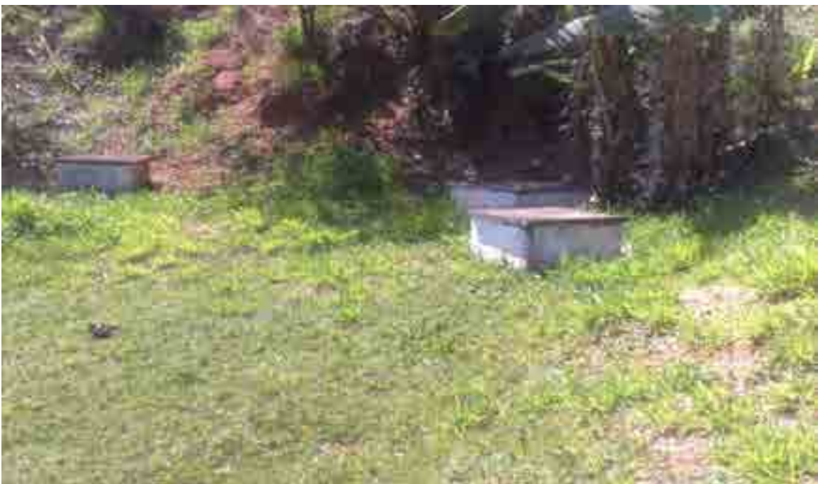
Foto: 30 – Visão externa das caixas de alvenaria, onde estão localizadas as minas de água (cada caixa representa uma mina).
