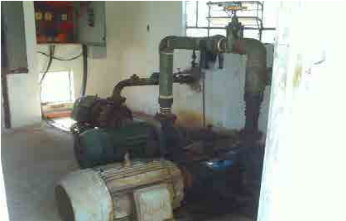
Foto: 35 – Bombas de recalque – 50 Cv e 40 Cv
