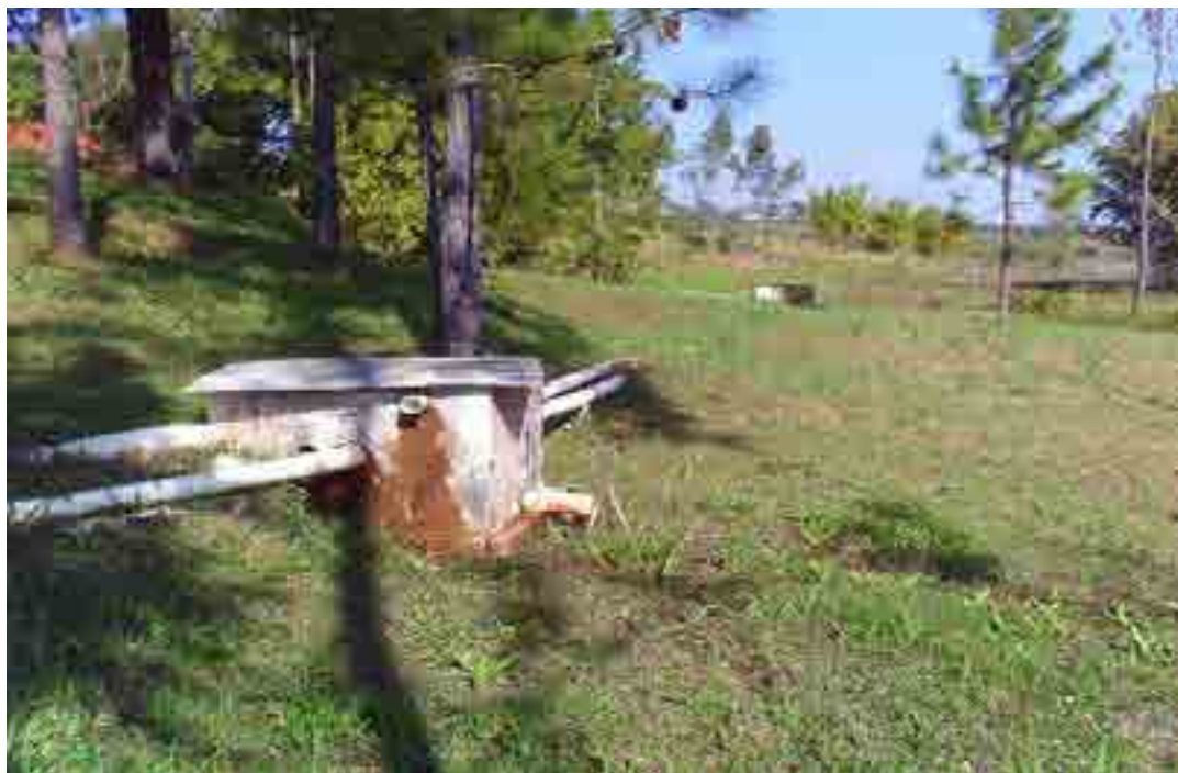
Foto: 17 – Caixa receptora da água das minas – Adução por gravidade
