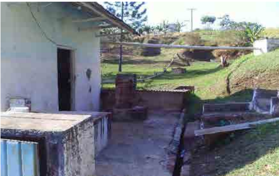
Foto: 28 – Visão parcial da casa das bombas – Ao fundo, rede de recalque.
