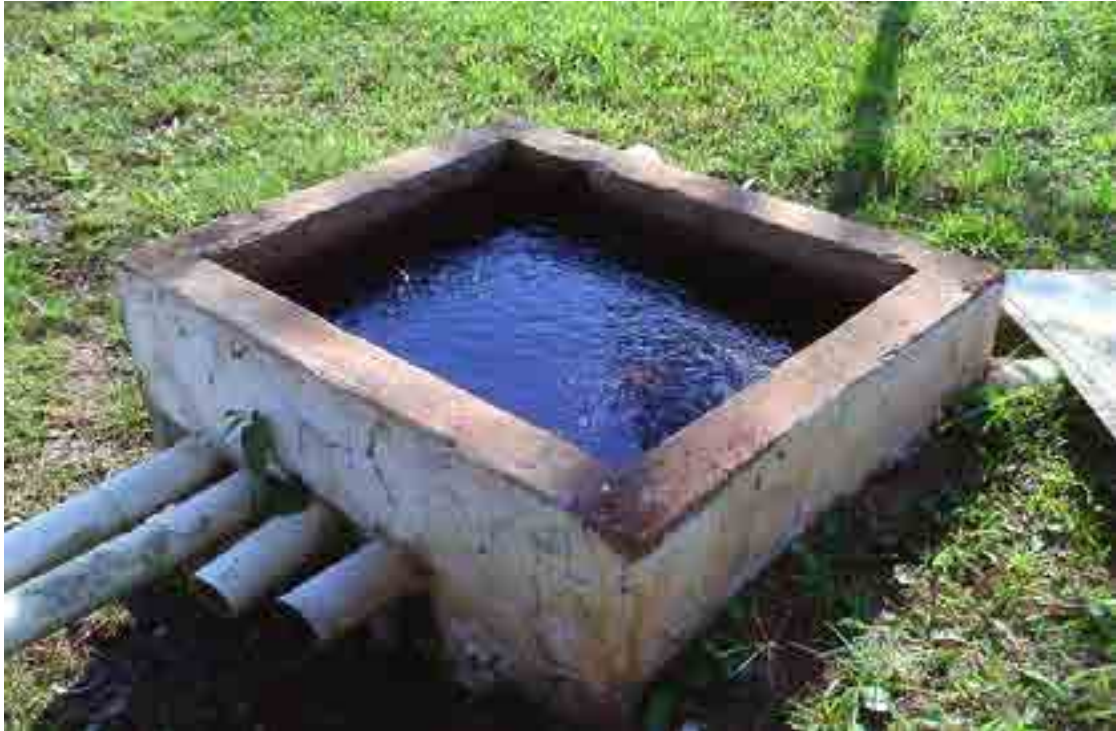
Foto: 19 – Caixa aberta de recepção e passagem da água das minas e também das represas, que seguem em direção ao reservatório semi-enterrado p/tratamento.
