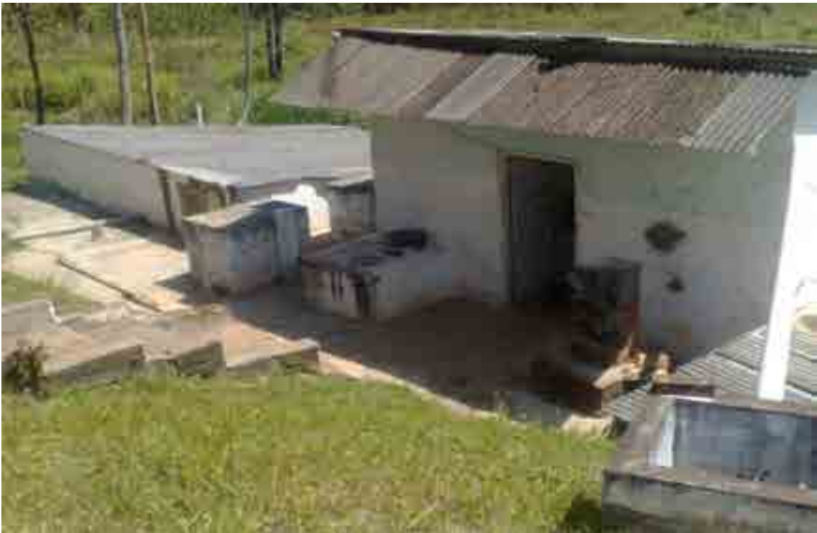
Foto: 27 – Visão lateral da casa das bombas e de 01(um) dos reservatórios semi-enterrado (nº. 2) – Capacidade de 25m 3 .
