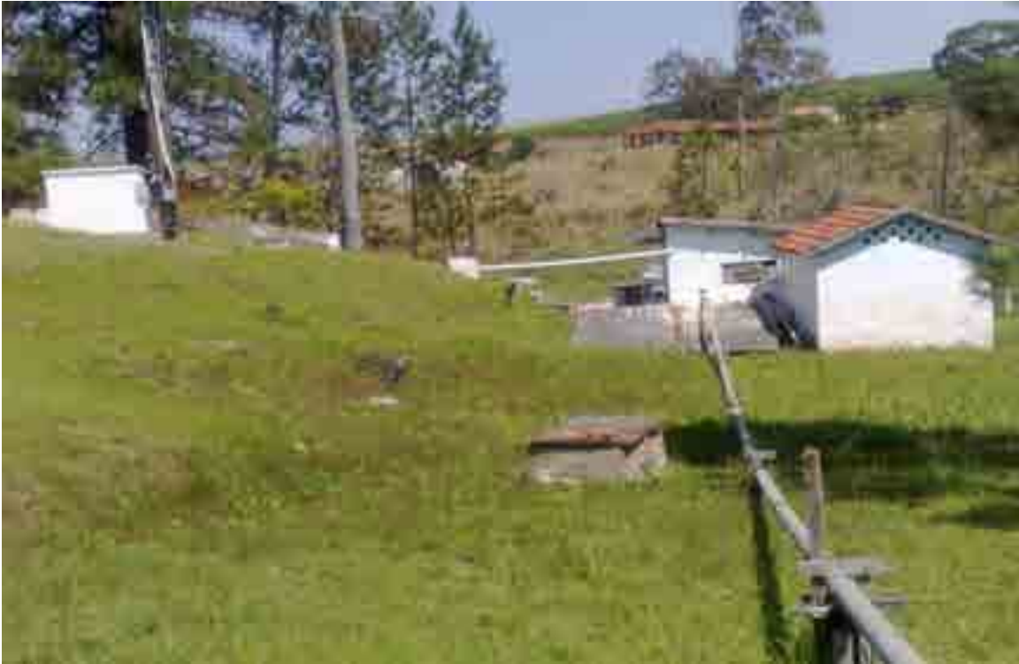
Foto: 29 – Visão lateral da casa das bombas. Nesta imagem temos vista parcial da rede de recalque, reservatório nº. 1 de recepção de água das minas e parte da rede de recalque de 100 mm.
