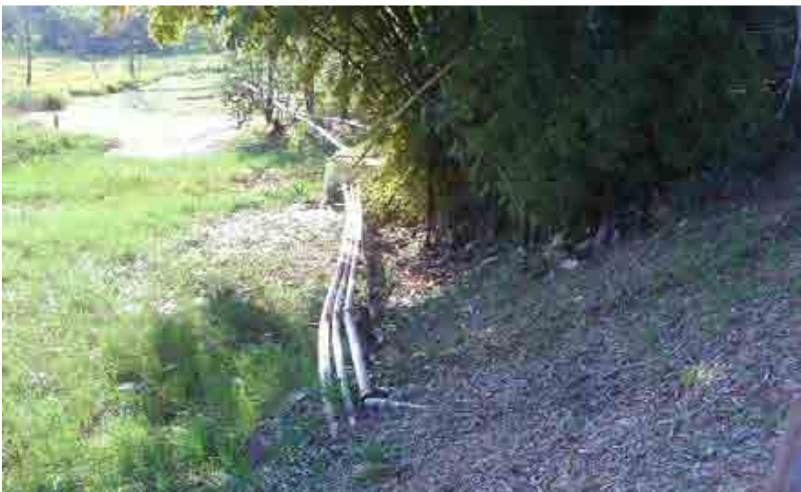
Foto: 22 – Rede de adução – Conduz por gravidade água das minas/represas até reservatórios semi-enterrado, que após tratamento com adição de cloro e flúor, é recalçada para os reservatórios da cidade e posterior distribuição.
